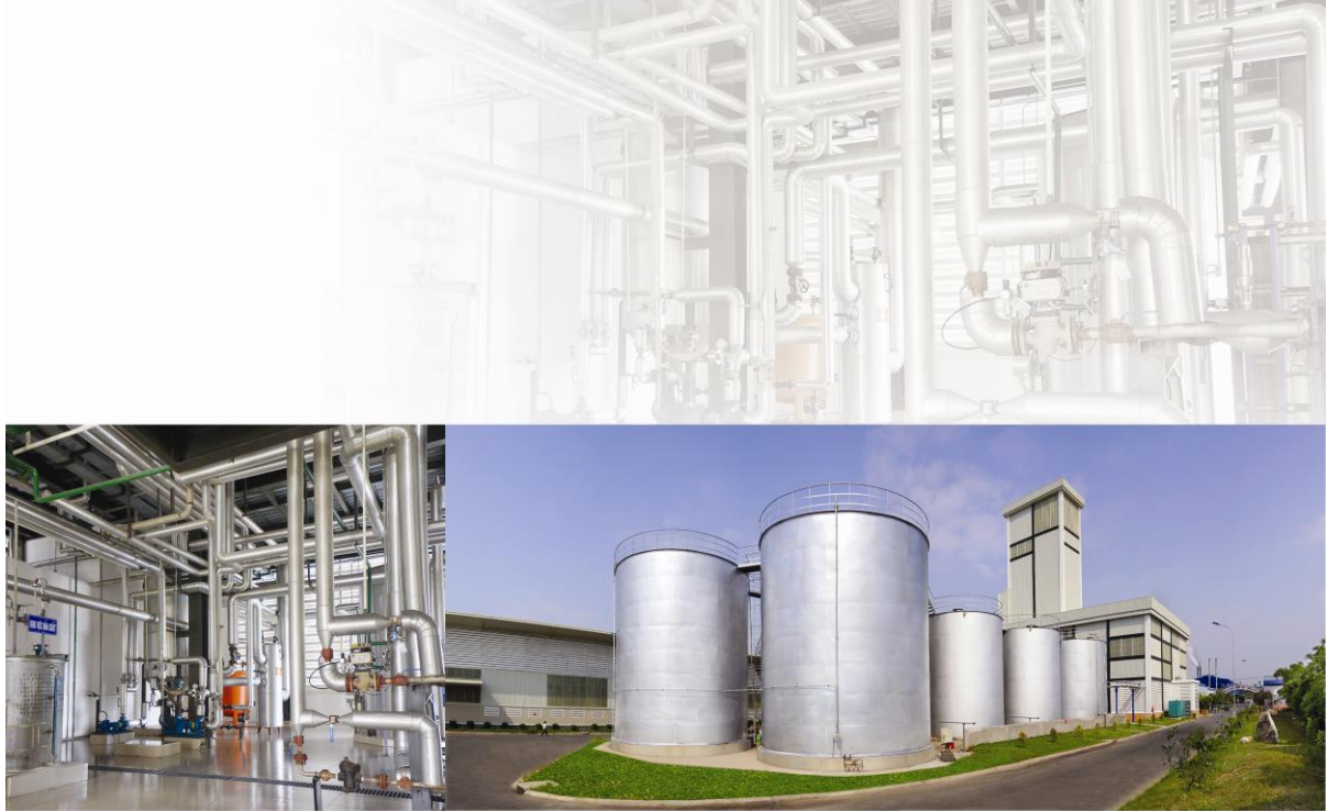
Hệ thống bồn chứa và trang thiết bị hiện đại của nhà máy tinh luyện dầu
